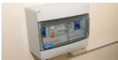
Le coffret électrique
